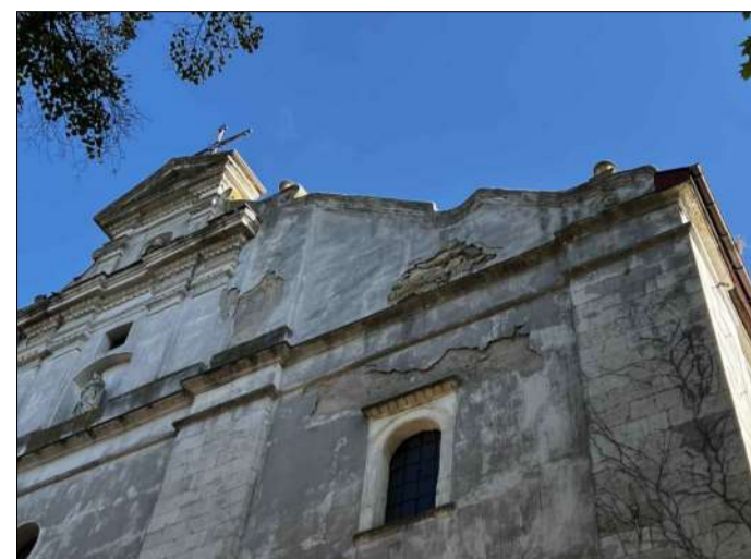
zakres ubytków /szczyt/
